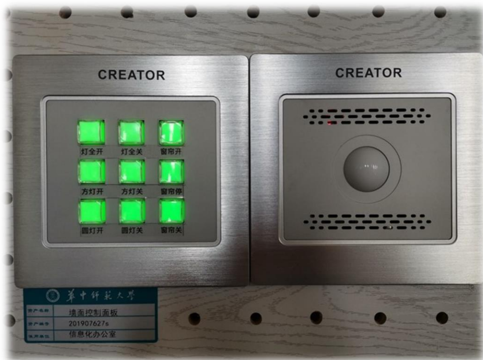
墙面控制面板
